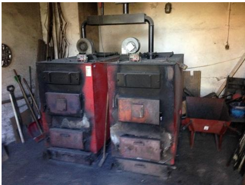
Kotłownia w budynku „starym” z dwoma kotłami węglowymi.
