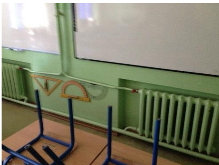
Typowe grzejniki żeliwne, członowe wraz z instalacją c.o.
